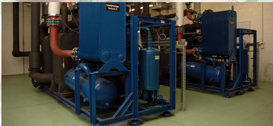
Die beiden Kälteanlagen sind redundant, können sich also gegenseitig ersetzen. Sie versorgen alle Kühler im Untergeschoss und einen Teil der Kühler im Erdgeschoss.
