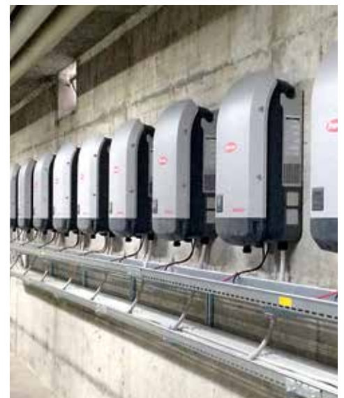
Hier sind 16 Wechselrichter im Einsatz.
